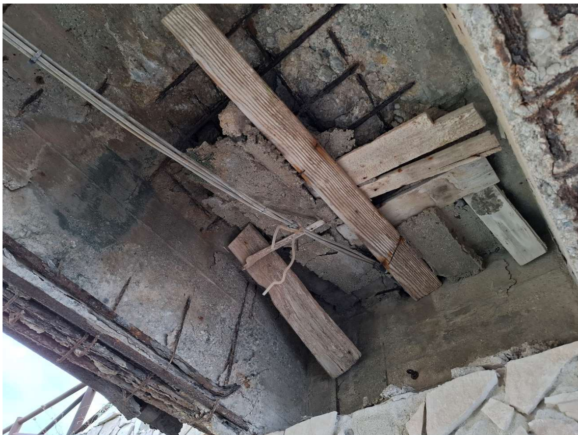
7- PARTE DELLA CALDANA DANNEGGIATA
