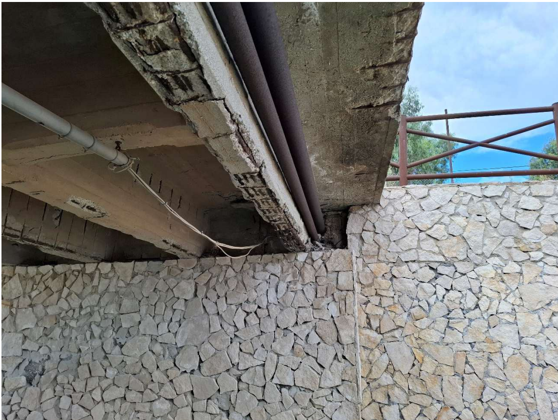
5- TRAVE DEL PONTE IN CATTIVO STATO DI MANUTENZIONE
