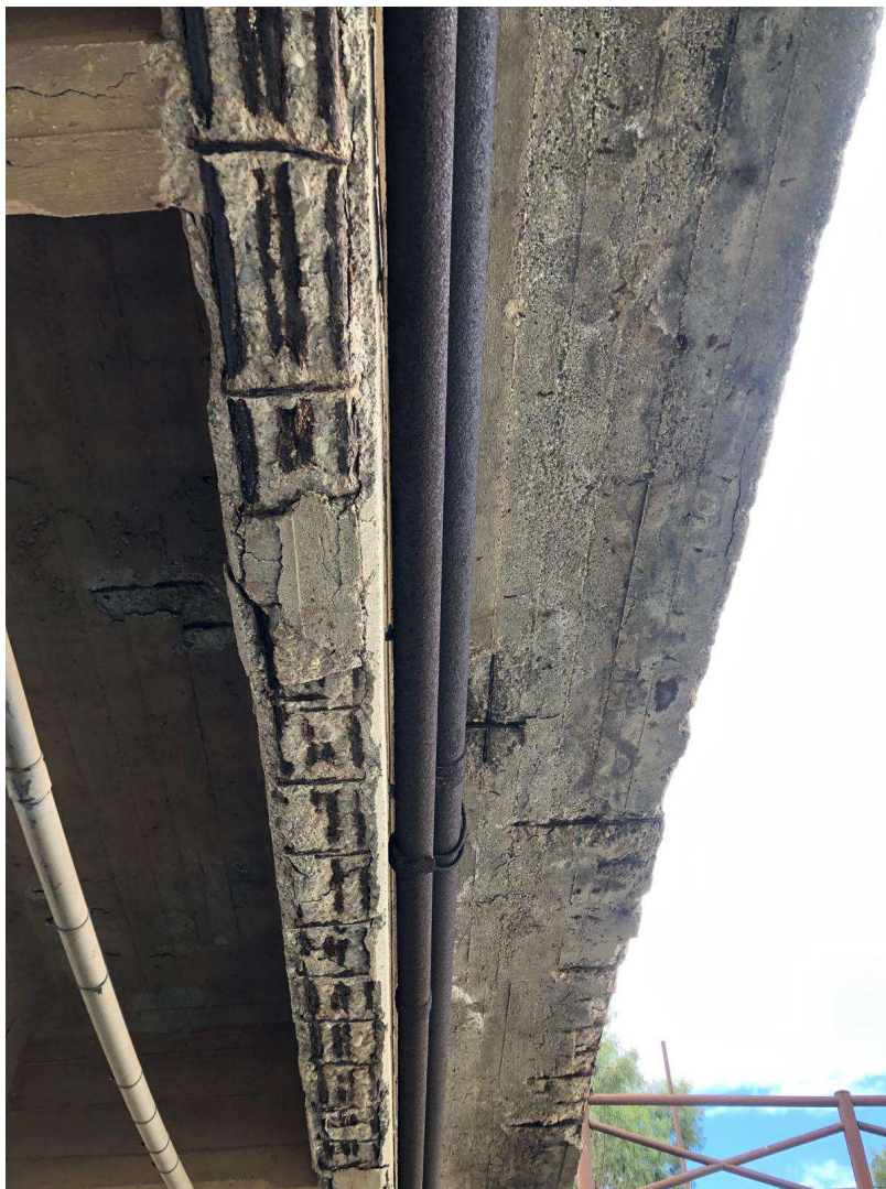
9- TRAVE DEL PONTE IN CATTIVO STATO DI MANUTENZIONE
