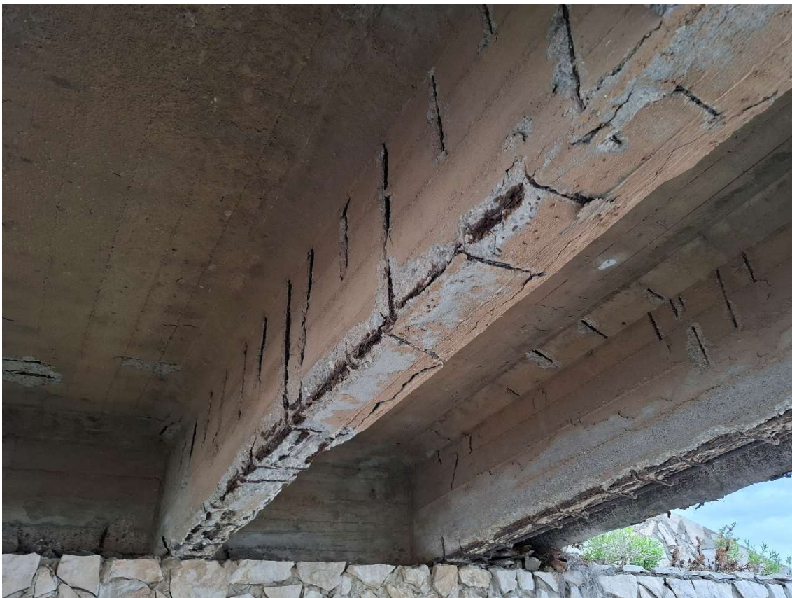
6- TRAVE DEL PONTE IN CATTIVO STATO DI MANUTENZIONE
