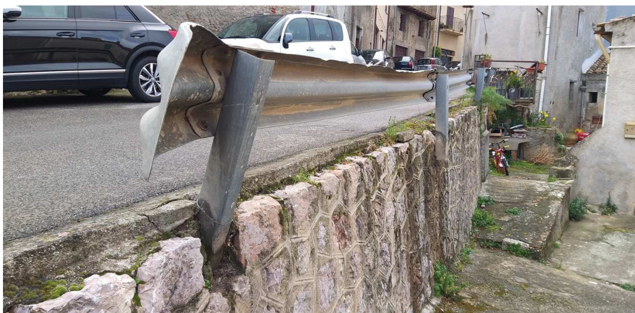
Foto N° 4: Tratto di guard rail in centro abitato da sostituire con ringhiera tipo Fracasso su cordolo.
