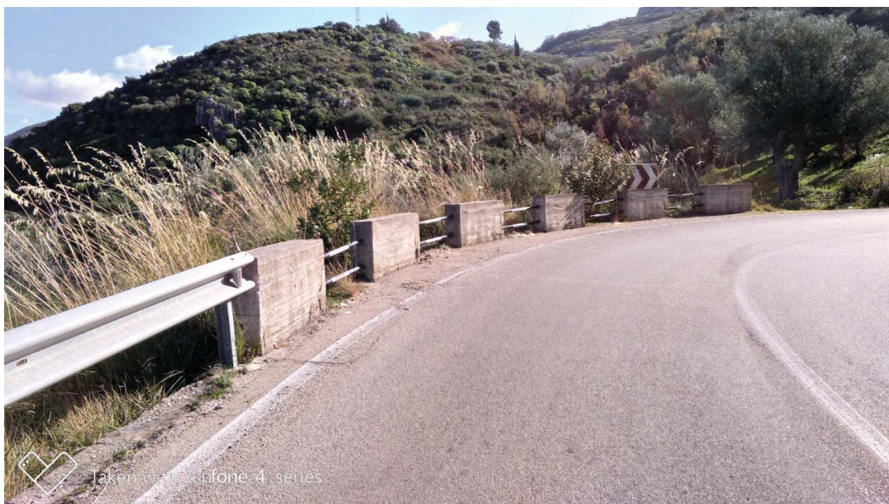
Foto N° 9: Altro tratto misto guard rail e parapetti obsoleti, da sostituire con nuova barriera H2.
