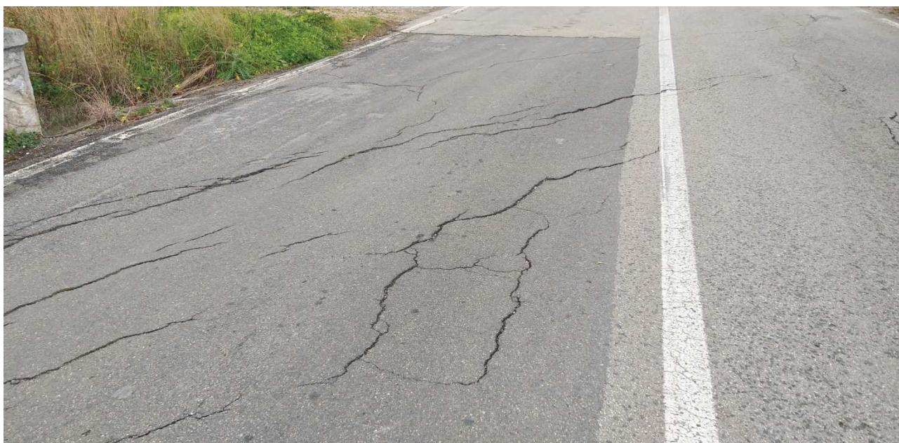
Foto N° 1: Tratto di piano viabile al km.2+450 con previsione di rifacimento del conglomerato bituminoso per l'intero spessore.
