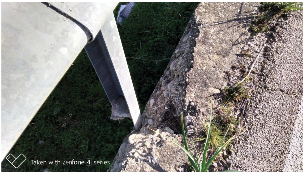
Foto N° 8: Altro tratto di guard rail obsoleto, da sostituire con nuova barriera H2 su manufatto.
