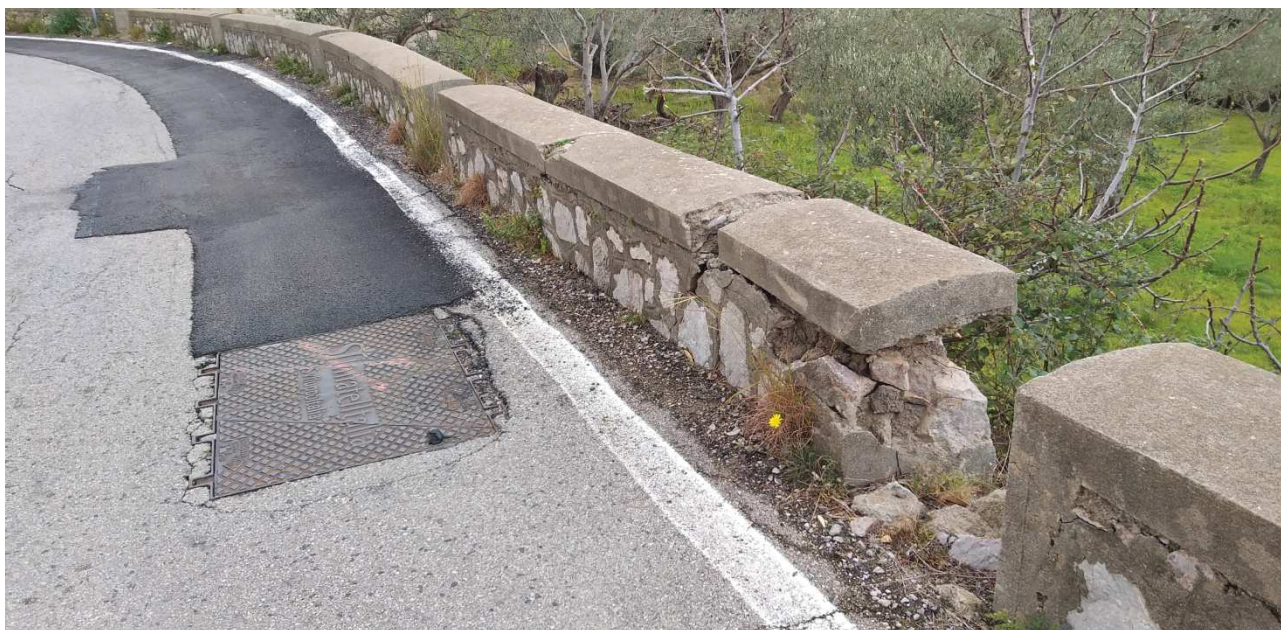
Foto N° 6: Tratto di parapetto da sostituire con nuovo parapetto in c.a. e paramento in pietrame.
