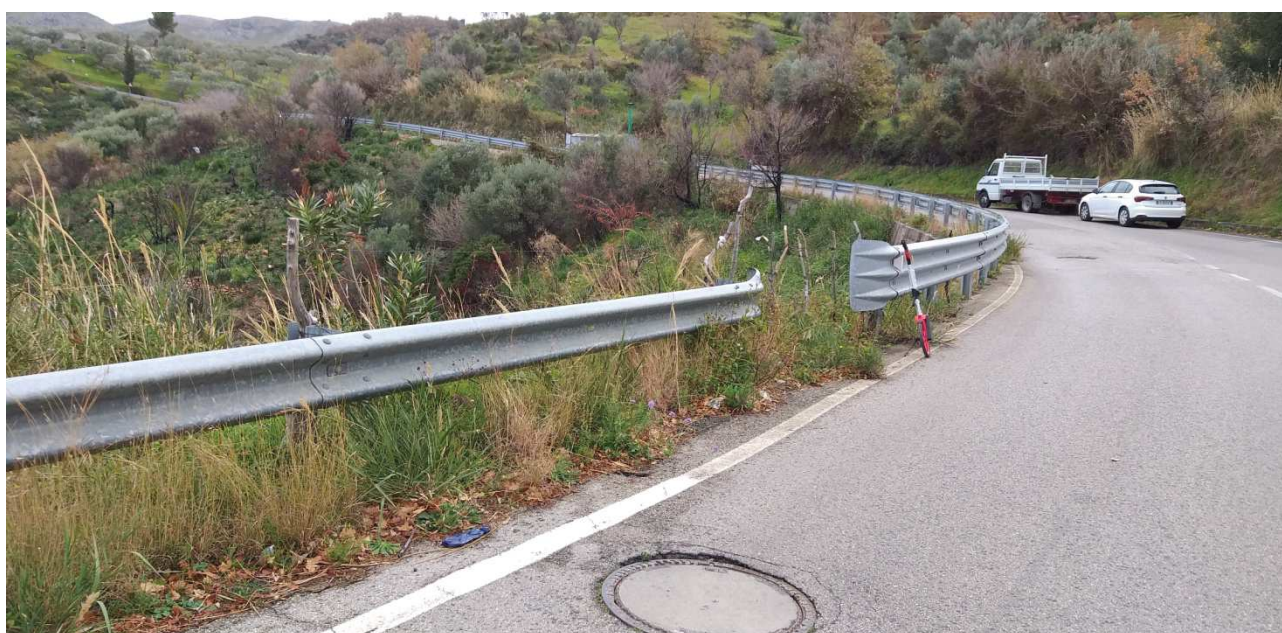
Foto N° 10: Tratti di guard rail di tipologia diversa, da uniformare con H2 tripla onda.
