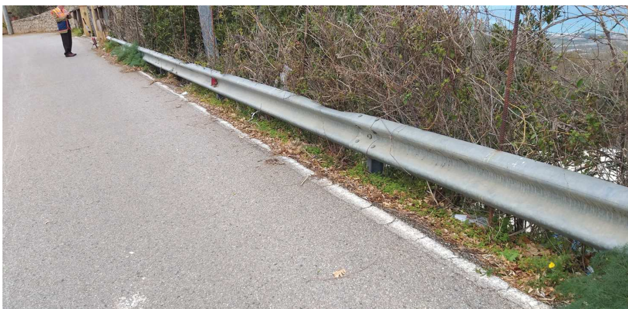
Foto N° 2: Tratto di guard rail con altezza e tipologia non adeguate.
