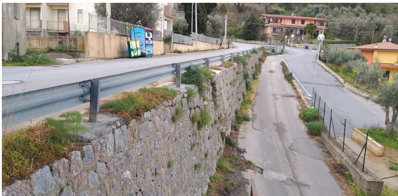
Foto N° 3: Tratto di guard rail fuori norma al km. 5+160 da sostituire con parapetto in c. a. e paramento in pietrame.
