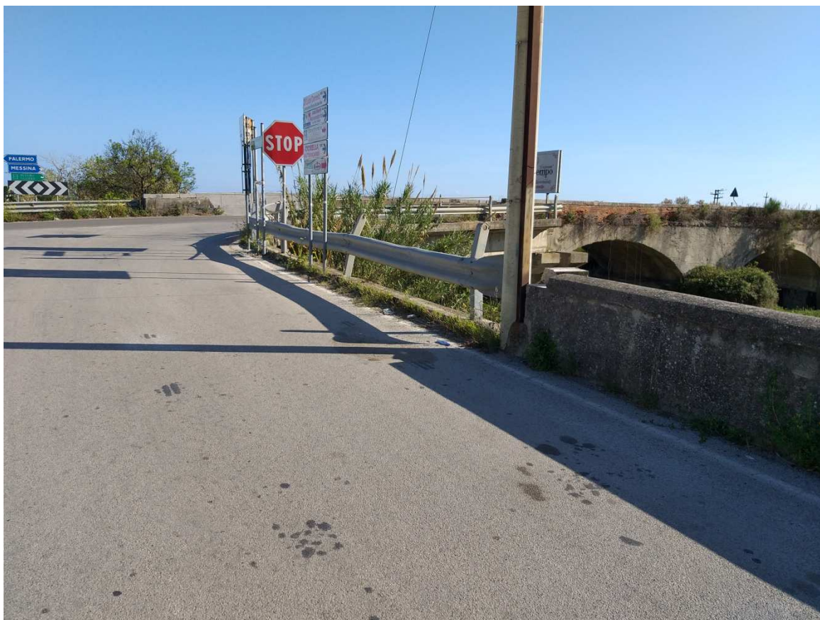
Foto N° 2: Tratto di barriera metallica di sicurezza da sostituire al km. 0+000 della S. P. 146 bis, lato sinistro.
