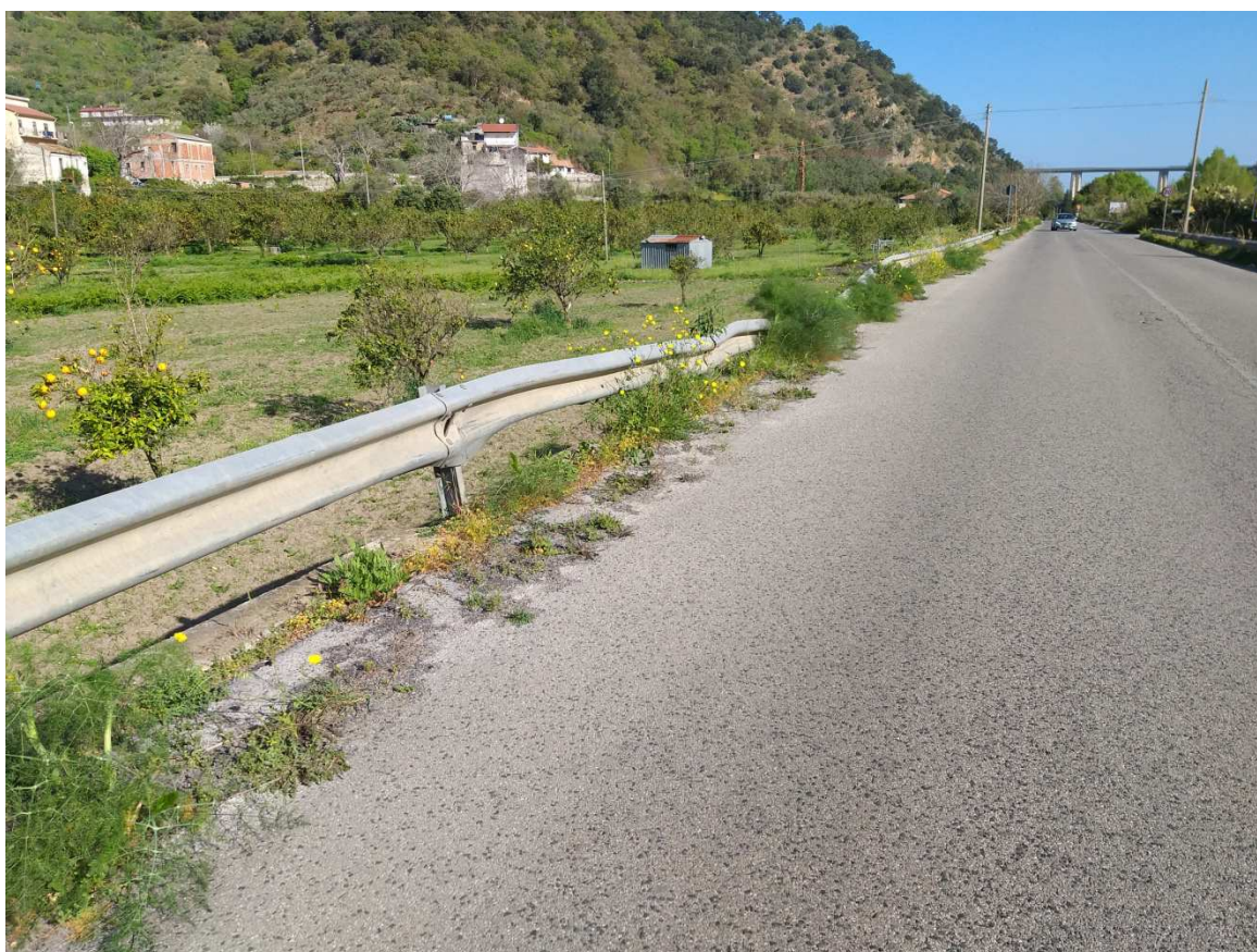
Foto N° 5: Tratto di barriera metallica di sicurezza danneggiata, da sostituire sul lato destro della carreggiata.
