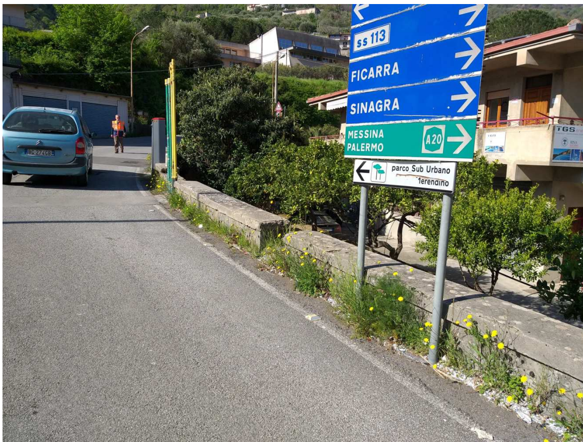
Foto N° 6: Parapetto in muratura di pietrame ubicato all'inizio del tratto della S. P. 145 Sinagra – Limari, da rialzare con sostituzione della copertina in c.l.s..
