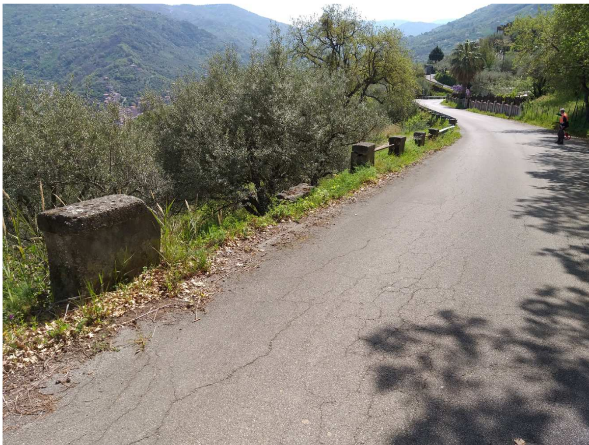
Foto N° 9: Altro tratto misto guard rail e parapetti obsoleti, da sostituire con nuova barriera H2 su manufatto.
