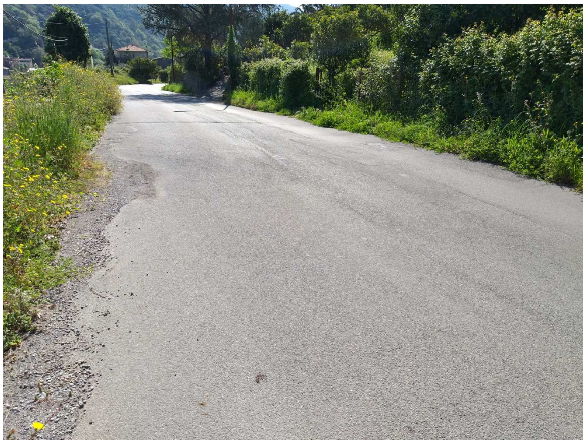
Foto N° 7: Tratto di carreggiata stradale da risagomare sulla S. P. 145 Sinagra – Limari.
