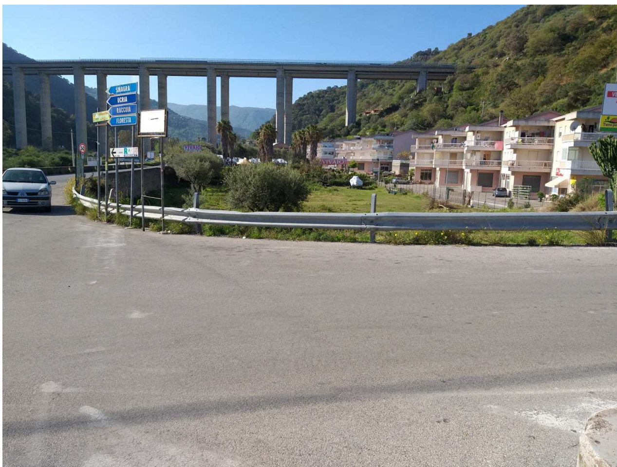
Foto N° 1: Tratto di barriera metallica di sicurezza da sostituire al km. 0+000 della S. P. 146 bis, lato destro.
